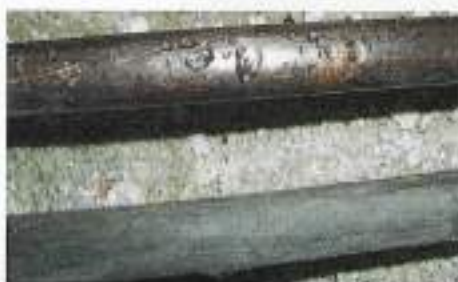
Tubo hidráulico dañado
