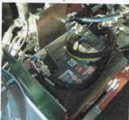
29. Batería arranque motor de explosión
