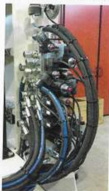
14. Grupo hidráulico principal
